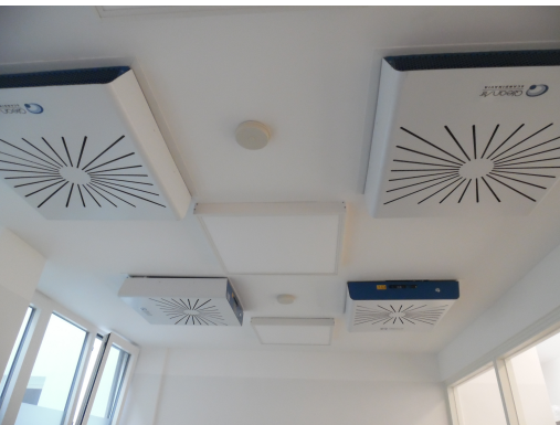
Deze ruimte wordt constant geventileerd
